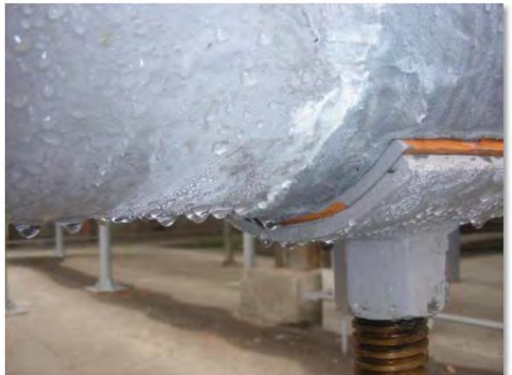
結露環境下にある配管
