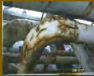
腐食状況 (施工前)
