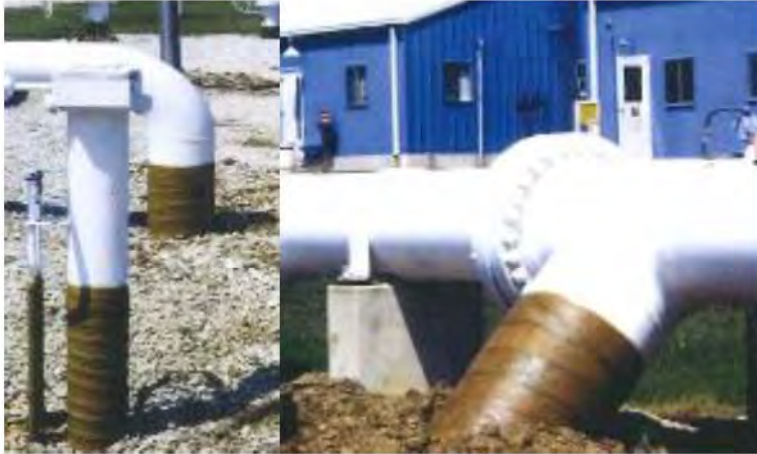
地下からの立ち上がり管
