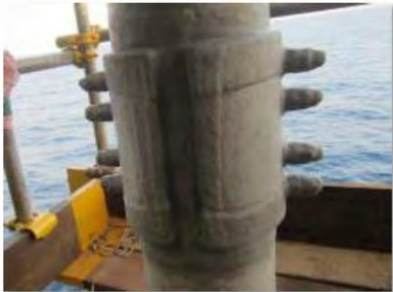
腐食しやすい環境
