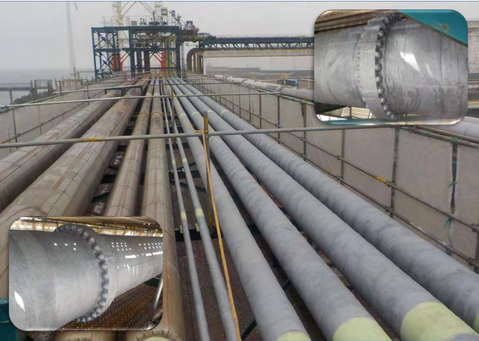
国内 プラント配管
