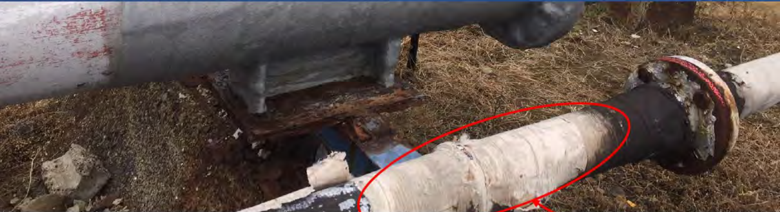
国内某製油所 ペトロラタムテープ設置後約10年経過状況 (屋外暴露)
