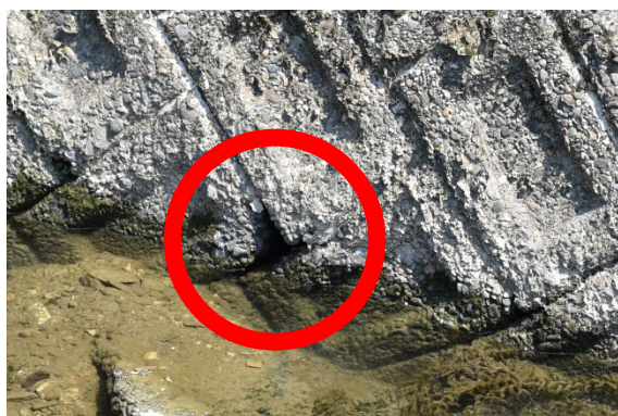
施工前の漏水箇所
