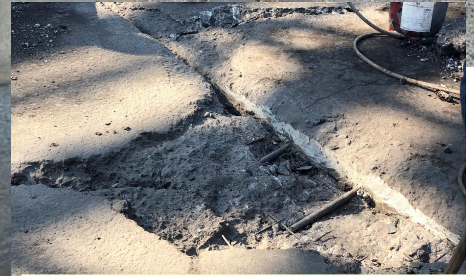
コンクリート床版路面の損傷
