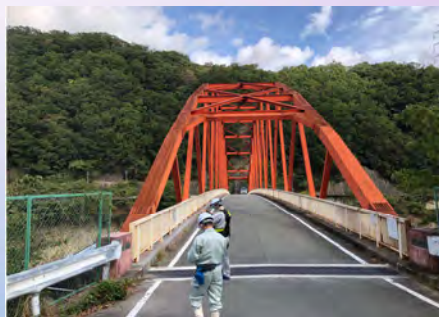
(2) ランガー橋 添接部剥離
