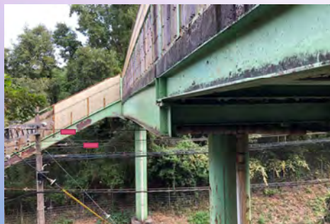
(1) 跨線歩道橋 点検部剥離
