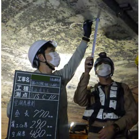
▼施工時確認の巻厚、空洞厚
