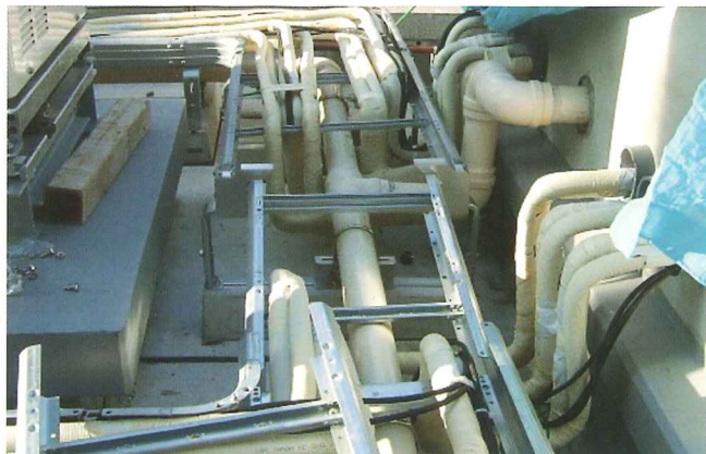
ビル屋上ガス配管（カラー鋼管 80 mm）
