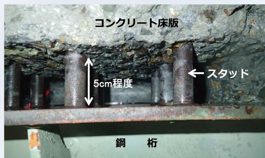
鋼桁と床版の分離状況
