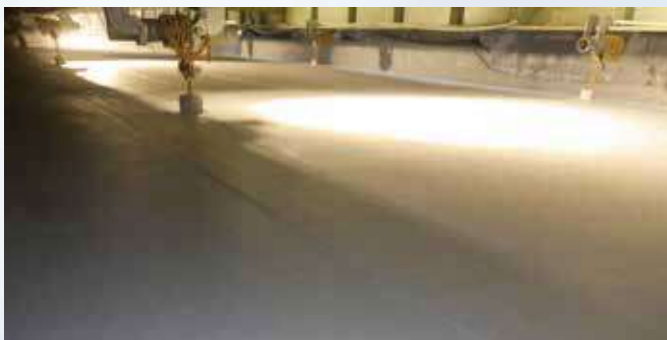
防水・防音吊り足場(漏水検知システム)
