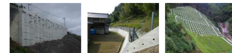
能登半島地震・輪島市深見 原急傾斜 尾口法面
