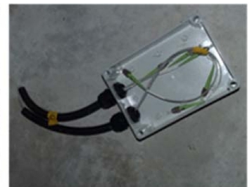
④ 再計測用コネクタ (桁内)
