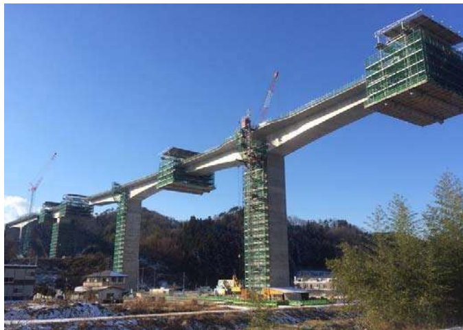
国道 115 号月館高架橋上部工工事 PC ケーブル緊張作業時(2016年1月撮影)
